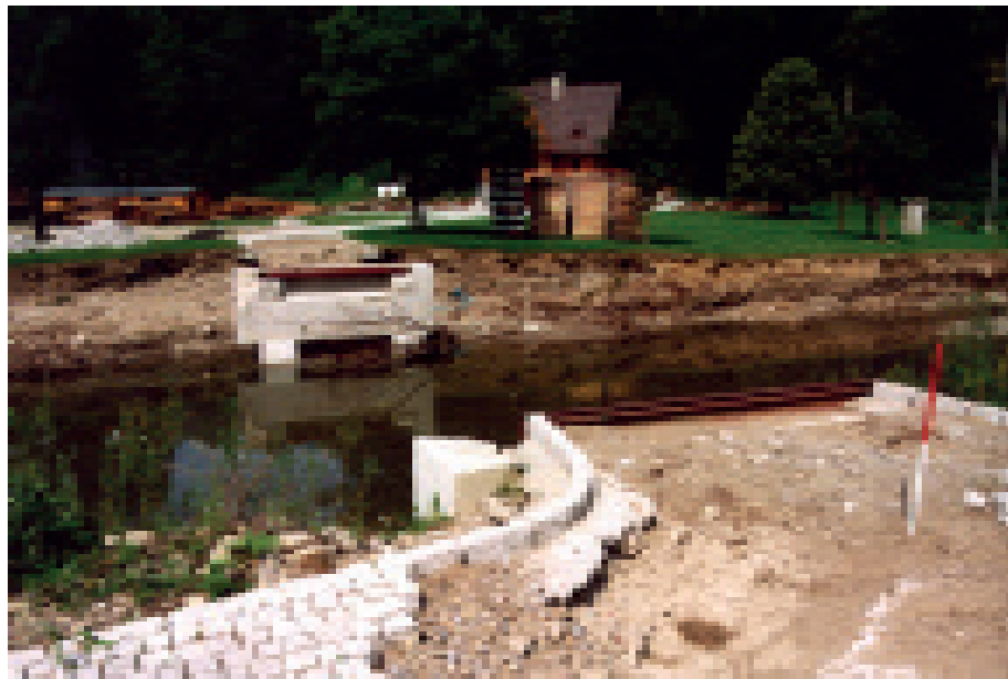
Fot. 1. Zniszczony nowy most stalowy w Polanach podczas powodzi (odc. 14)
