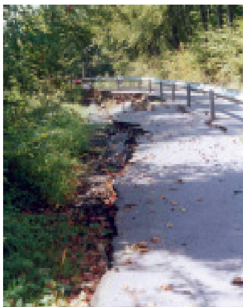
Fot. 5. Droga wojewódzka Limanowa-Nowy Sącz w Łaskowej zniszczona przez procesy osuwiskowe na krawędzi terasy Łososiny
