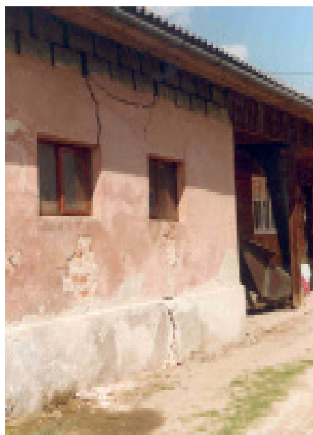
Fot. 4. Jeden z sześciu zniszczonych budynków na osuwisku w Stańkowej
